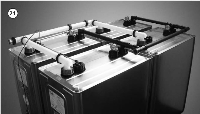
Fertig montierte Leitungssysteme (Beispiel Blockaufstellung 4 Stück DWT plus 3 1000 l). Completed piping systems (example: block installation 4 units DWT plus 3 1000 l). Systèmes de conduite complètement montés (exemple, installation en blocs, 4 pièces DWT plus 3 1000 l). Af gemonteerde leidingsystemen (voorbeeld blokopstelling 4 stuks DWT plus 3 1000 l).
