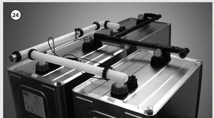
Fertig montierte Leitungssysteme (Beispiel Winkelaufstellung 3 Stück DWT plus 3 1000 l). Completed piping systems (example: angled installation 3 units DWT plus 3 1000 l). Systèmes de conduite complètement montés (exemple, installation angulaire, 3 pièces DWT plus 3 1000 l). Af gemonteerde leidingsystemen (voorbeeld hoekopstelling 3 stuks DWT plus 3 1000 l).
