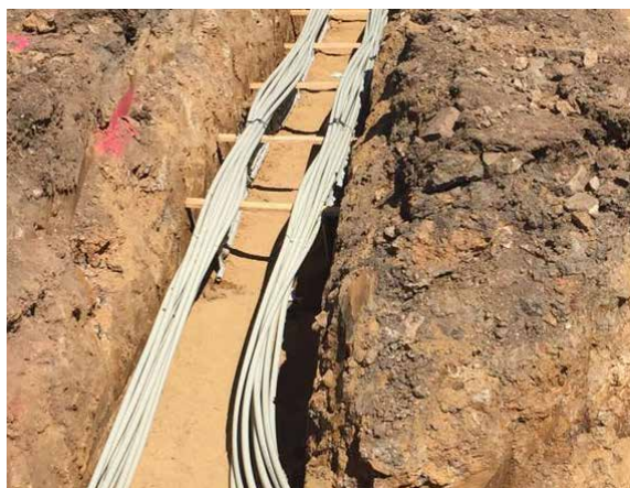
Vorläufe auf der einen, Rückläufe auf der anderen Seite, oberhalb der Kollektoren fixiert
