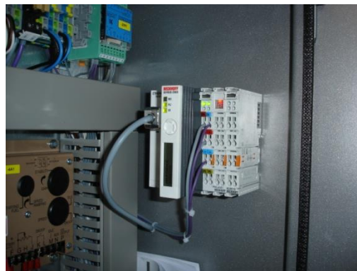
Abb. 2 Gateway an der Seitenwand des BHKW-Schaltschranks EM-140/207
