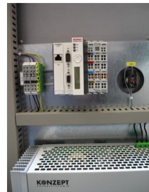
Abb. 3 Gateway in der Schaltschranktür des BHKW EM-238/363
