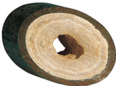
Beispiel für Korrosion und Kalkablagerungen
