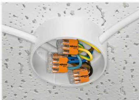
Leuchtenverteilung in Deckenbaldachin
