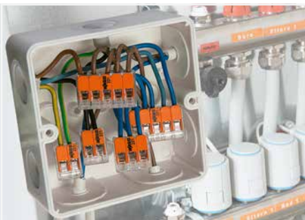
Verdrahtung feindrätiger Leiter in Installationsdosen bei Fußbodenheizung
