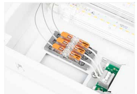
Mehrpole, lagefixierte Verdrahtung einer Leuchte
