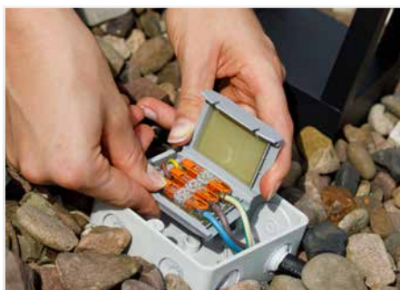
Anschluss einer Wegeleuchte
