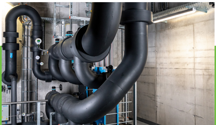
Die Fernwärmeleitungen in der Zentrale der IBC Chur
